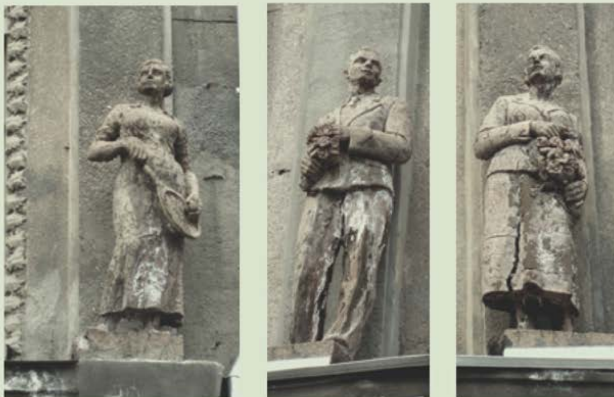
Дом ИТР завода им. Ленина. 1936-37 гг. Арх.-худ. А.С. Шеремет. Скульптуры на фасаде дома. Фото 2009 г.
