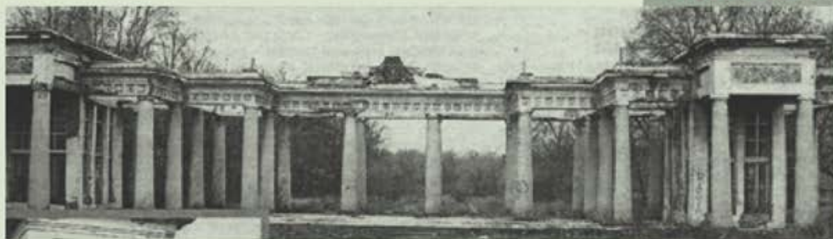
ПКиО им. Горького. Разрушенный парадный вход в парк. Фото 2009 г.
